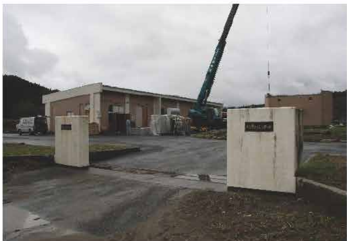
写真1 津波により浸水した陸前高田市竹駒水源 津波により塩分が高くなったため飲み水として使用できない状態が続いたが、関西地域の水道事業体や民間企業の支援により、利用できるまで復旧した。
